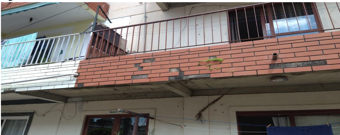
Fonte: Autoria Própria Descolamento de revestimento e manchas de umidade
