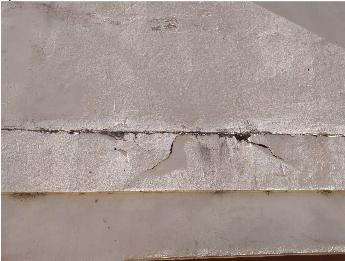
Fonte: Autoria Própria Trincas, Sujeira, Umidade (infiltração)
