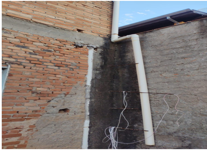
Figura 4 – Fotografia do ponto de concentração de patologia. (Fonte: Autoria própria).
