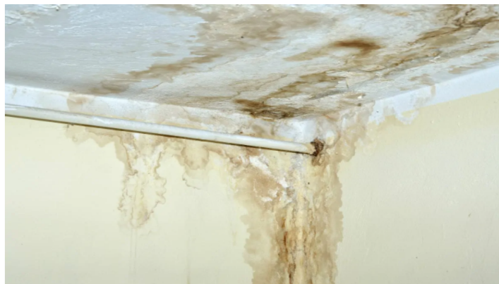
Figura 1 - Tipo de patologia dentro de uma edificação (Fonte: totalconstrução)
