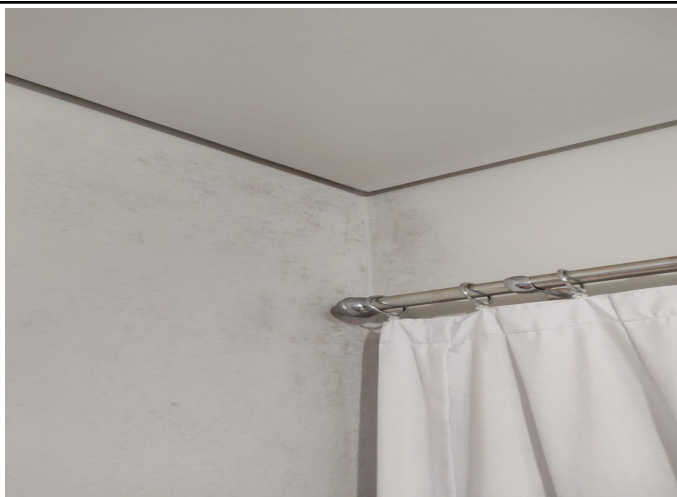
Figura 6 - Fotografia da área externa com a concentração de patologia. (Fonte: Autoria própria)
