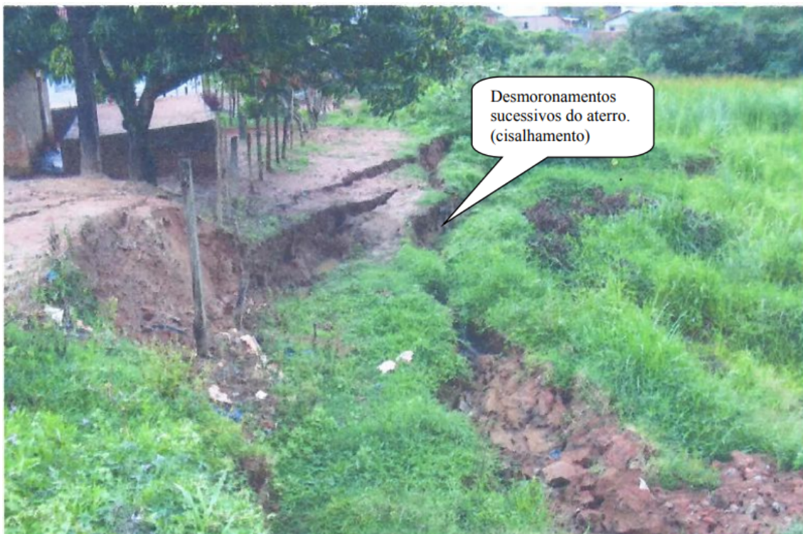
Foto 01: Desmoronamentos sucessivos do aterro. ( Sobre este aterro foi construída a edificação do autor, porém este aterro não foi feito de maneira adequada, ou seja, sem compactação suficiente e sem obras de contenção à jusante para estabilizá-lo. Fonte: Laudo SPT. )
