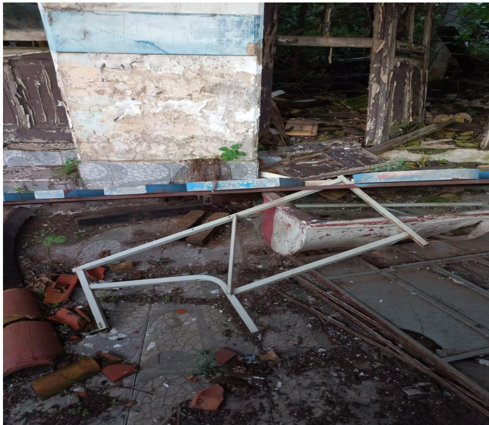
Figura 02: Interior do Hotel com vários entulhos
