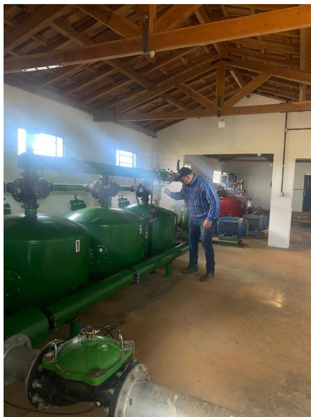
Figura 14 – Casa de Bombas do sistema de Irrigação
